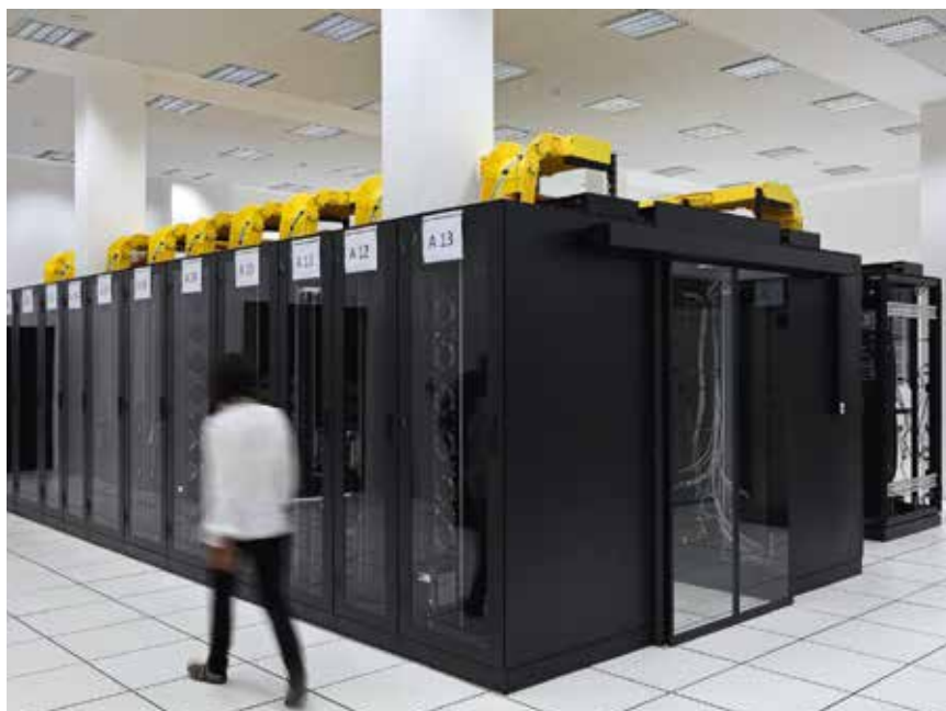
Data Center de CLS © CLS
